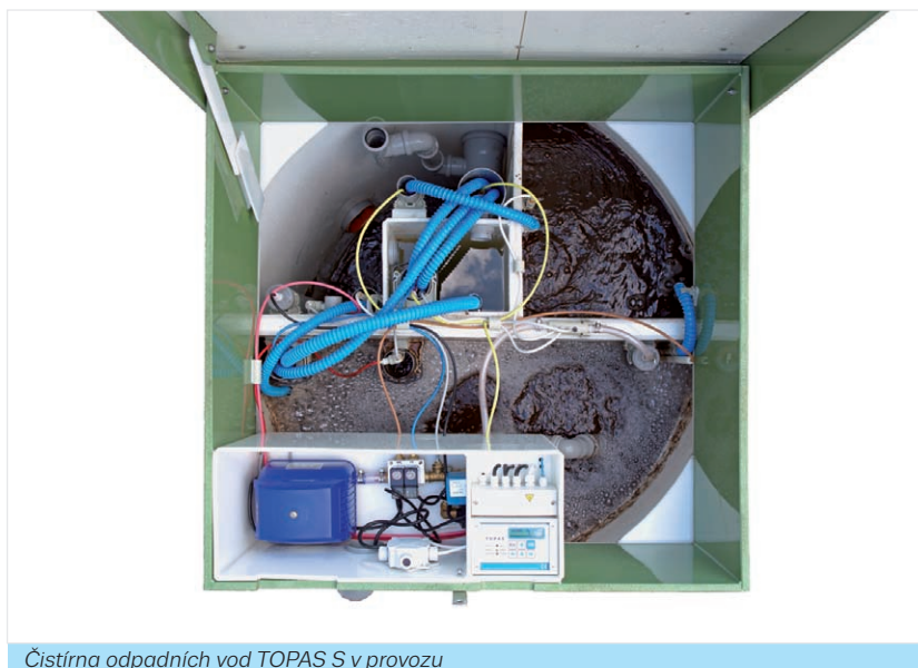
Čistírna odpadních vod TOPAS S v provozu
